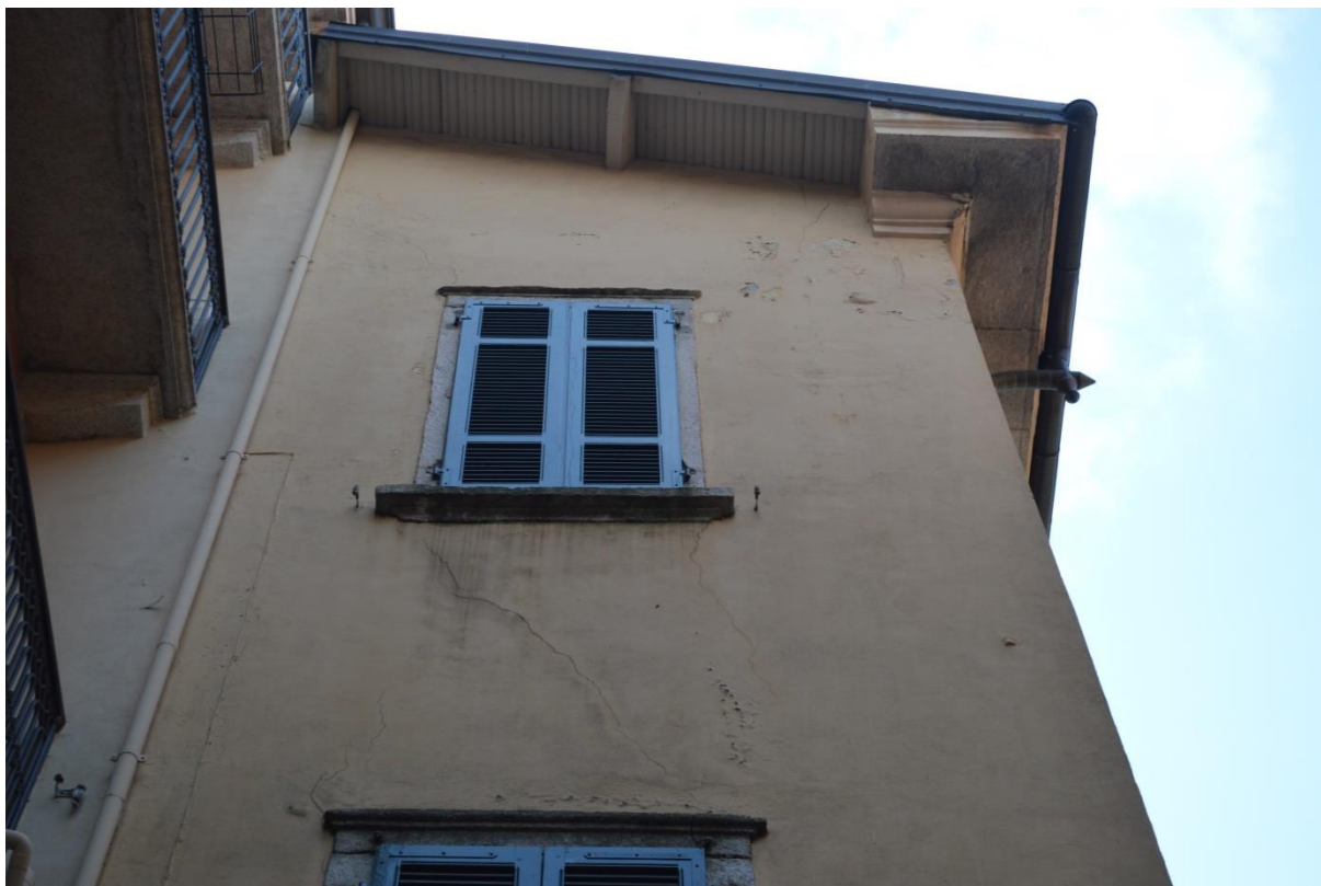
F17. Fronte nord, piano secondo
