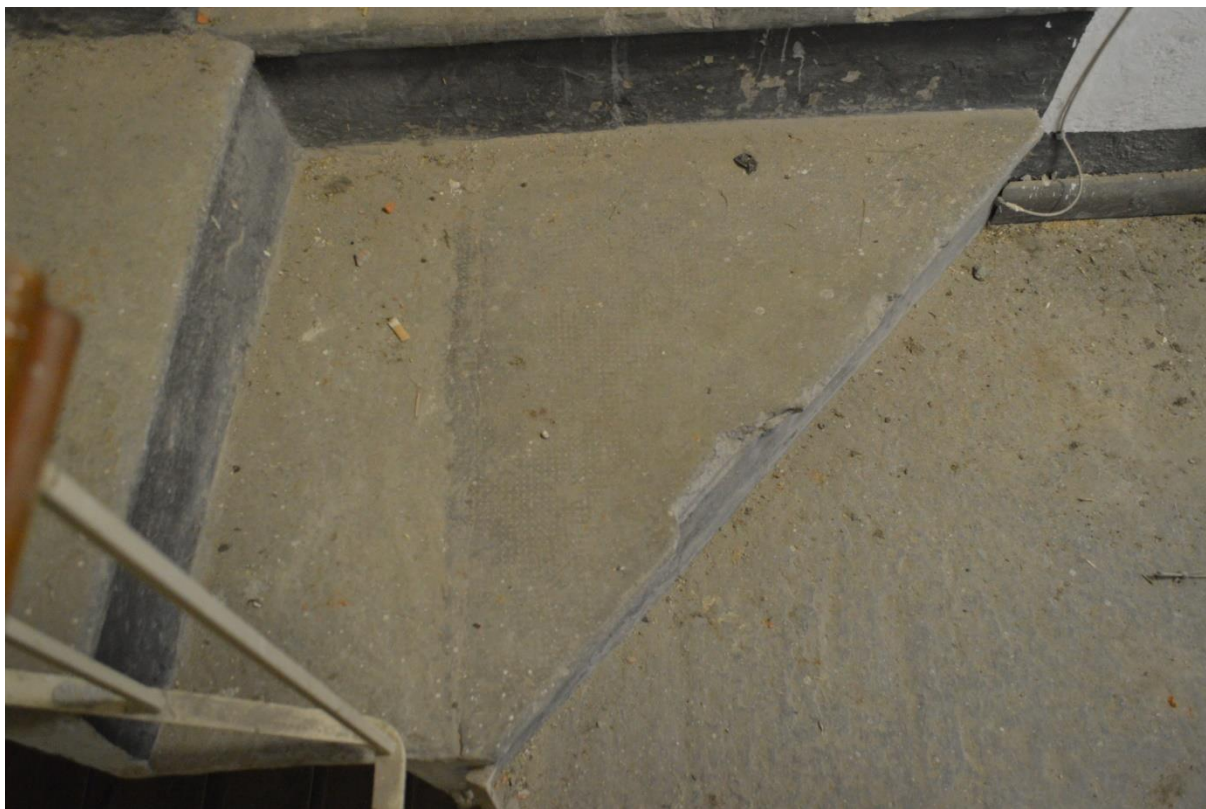
F96. Stato di fatto, locale P3.02 – Particolare dei gradini in battuto di cemento a imitazione di quello in pietra – Realizzati in un secondo momento per il collegamento con i locali tecnici
