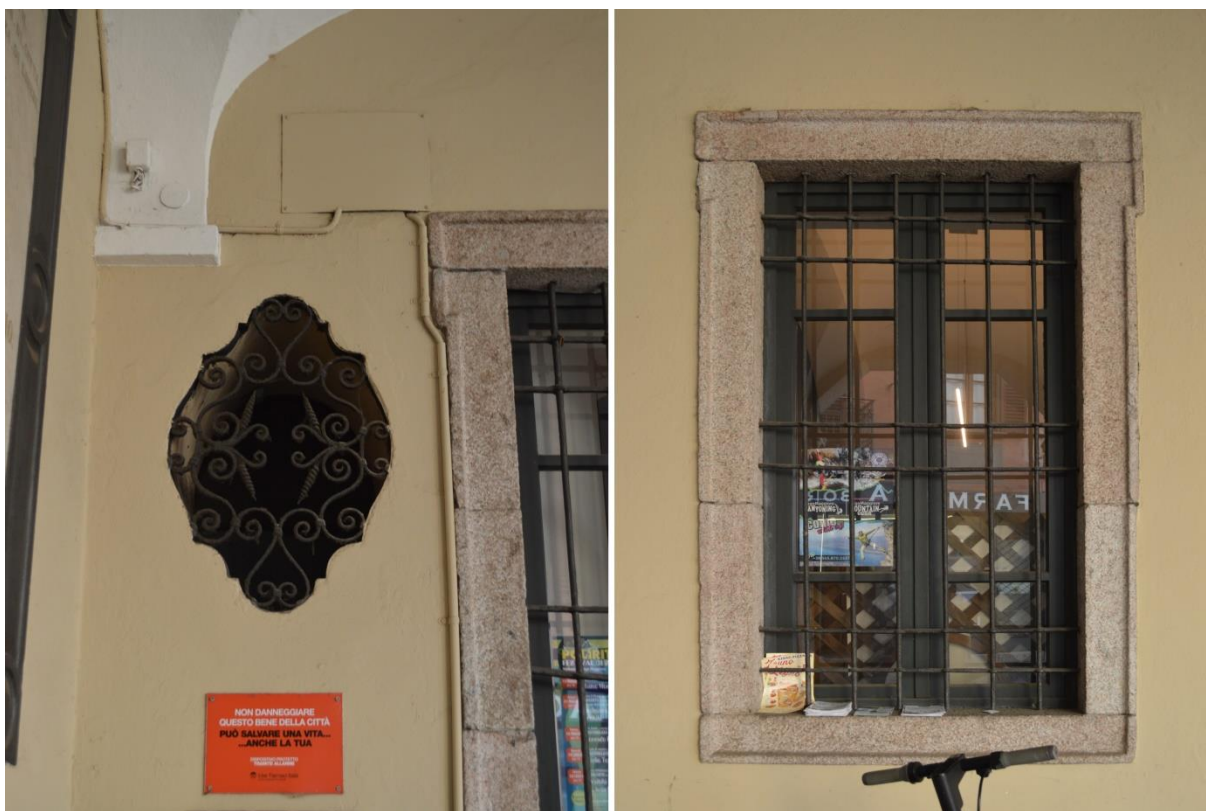
F26. Portico: particolari delle griglie di areazione con inferriate e finestre al piano terra con contorni in granito rosa
