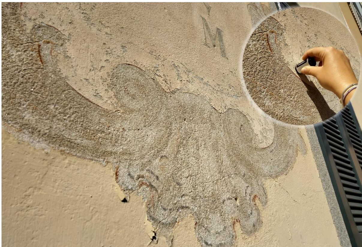
F27. Fronte sud, particolare della meridiana: il fondo originario è ancora ben visibile ed è stato possibile rilevare la tinta con spettrofotometro
