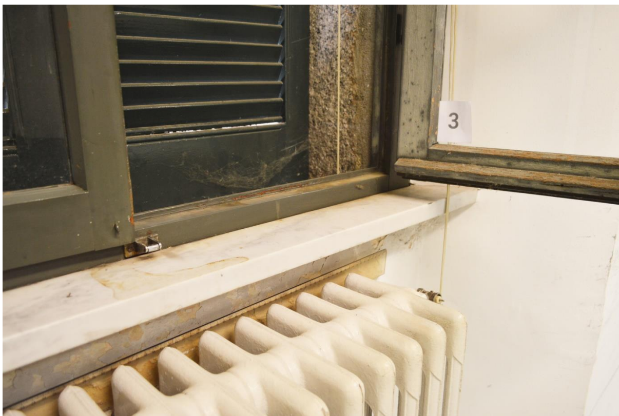
F71. Stato di fatto, locale P2.07 – Davanzali in marmo e serramenti anche internamente verniciati
