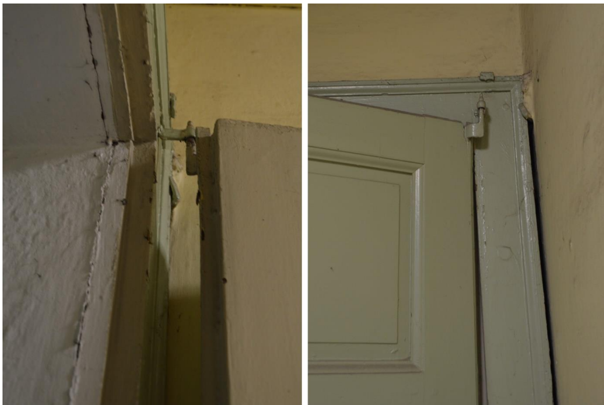
F86. Stato di fatto, locale P3.01 – Particolare della porta in legno esistente di ingresso con apertura eccentrica
