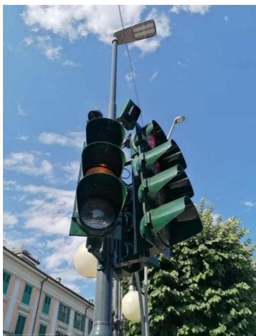
Figura: apparecchio per attraversamento pedonale, con tre lanterne semaforiche su palo, sensore di velocità e sistema di countdown per attraversamento
